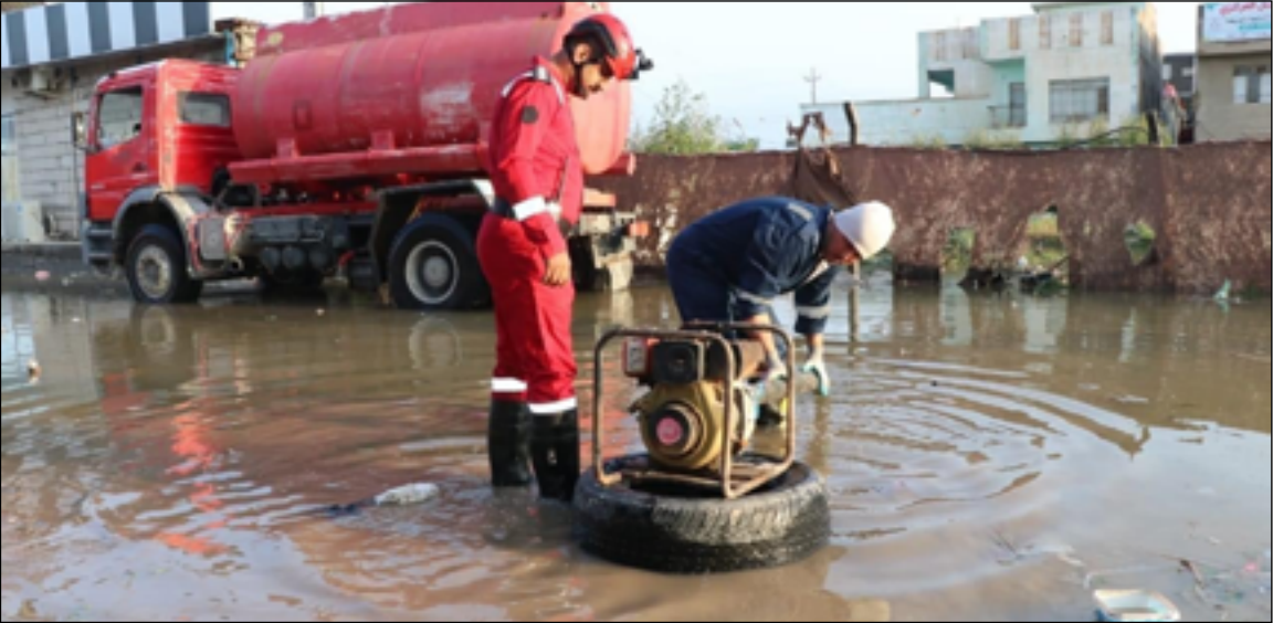
عمليات سحب مياه الامطار في الديوانية
