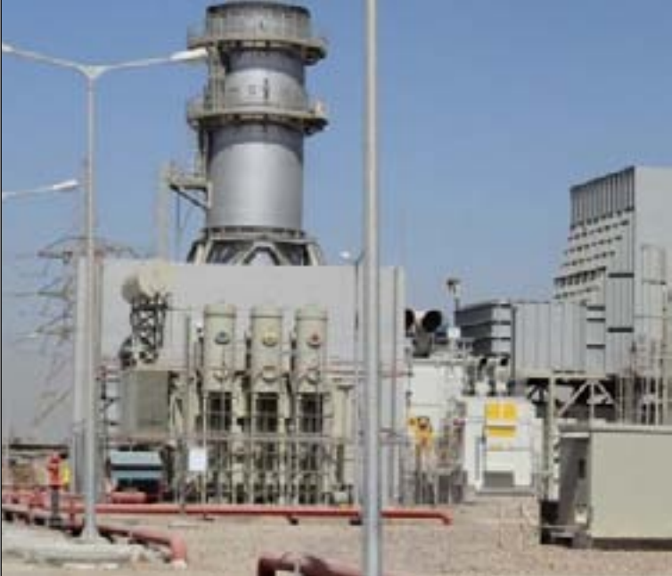
محطة لتوليد الطاقة الكهربائية
