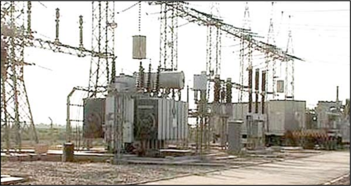
محطة كهربائية (أرشيف)
