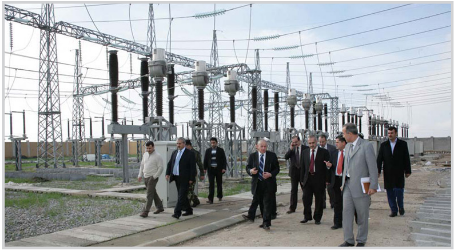
أحد مشاريع الطاقة الكهربائيّة في دهوك
