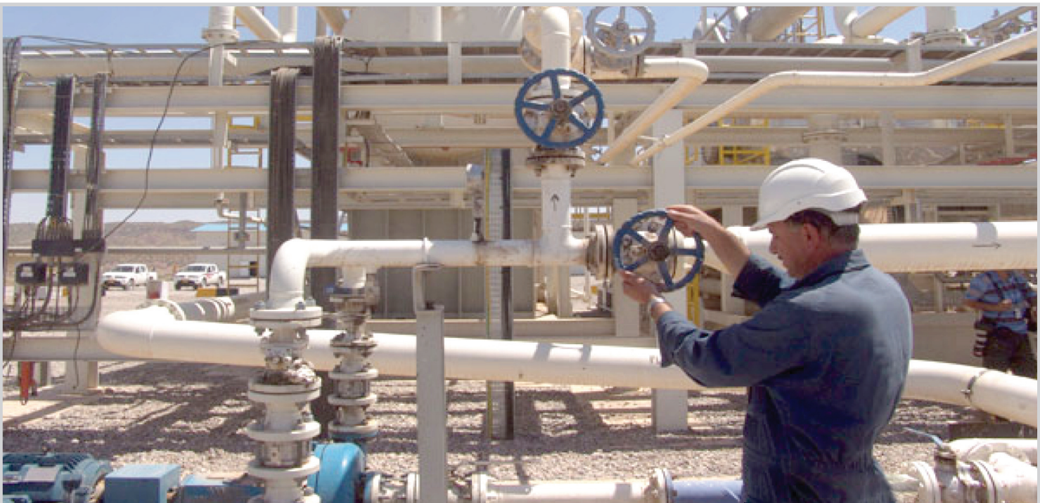
شبكة أنابيب ضخ النفط
