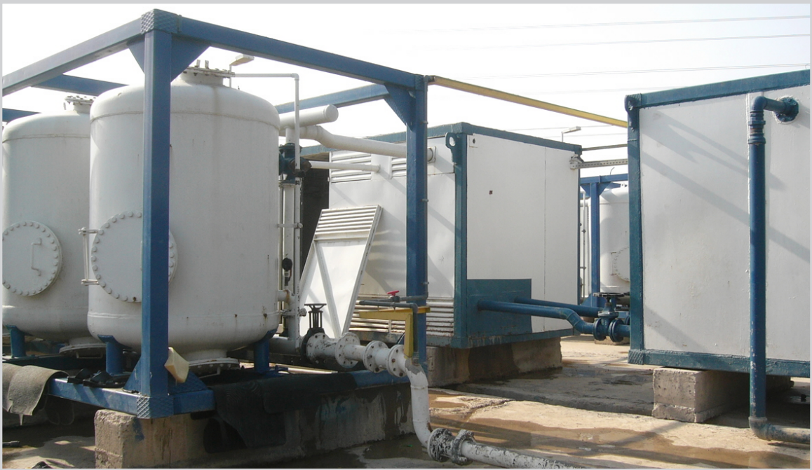
معمل لتصفية مياه الشرب
